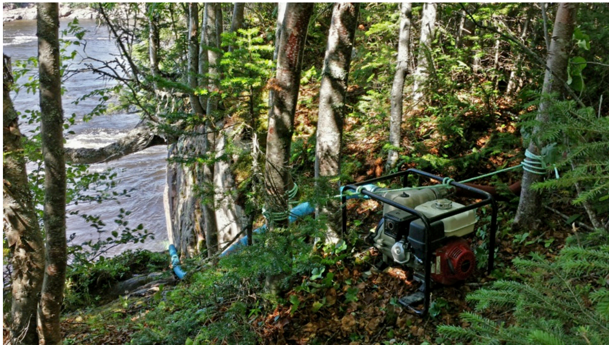
Photo 6.13 : Station de pompage pour l'alimentation en eau du bac de transfert
