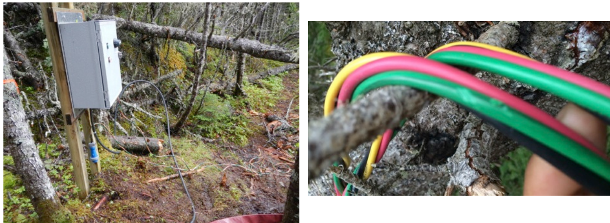
Photo 6.14 : Panneau électrique en bordure de rivière et fils grugés par les rongeurs
