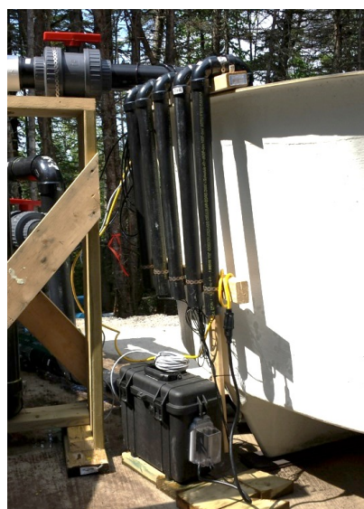
Photo 6.7 : Ordinateur de contrôle de la qualité de l'eau
